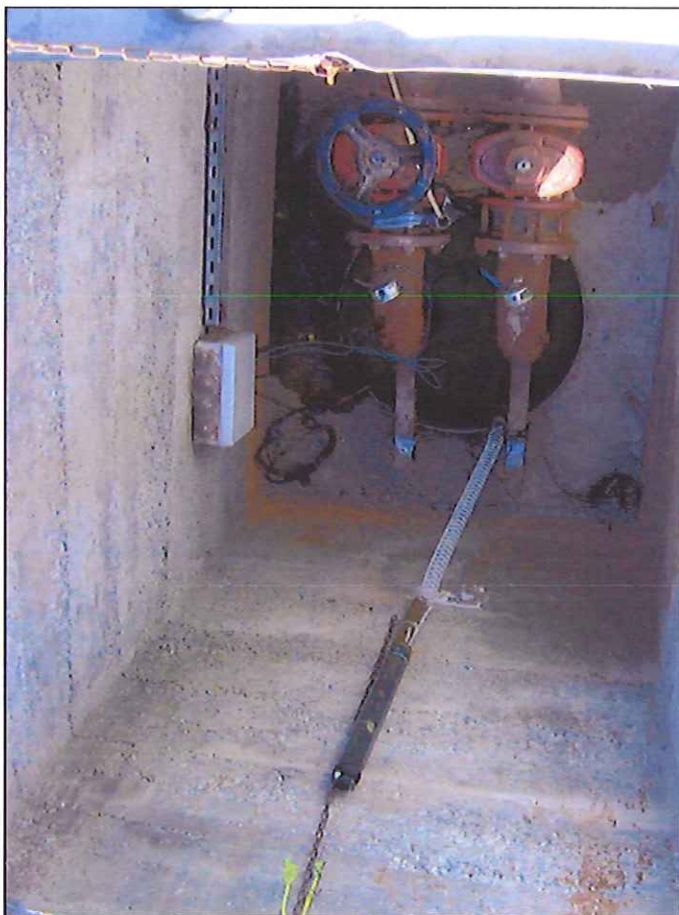
Photo 5 : Tête du puits de captage
